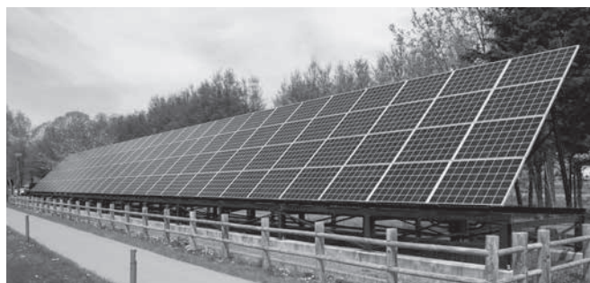
▲パワーコンディショナーを一新した屋外太陽光発電設備
